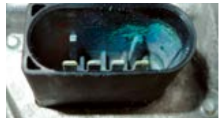
Beépíthető dugasz korróziónyomokkal
