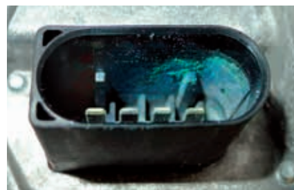
Ugrađeni utikač sa tragovima korozije
