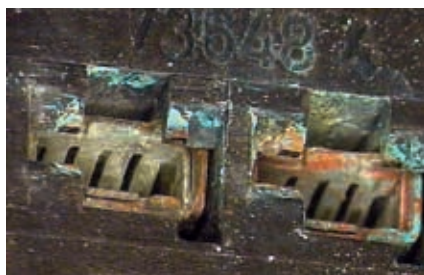
Konektor sa vlagom i tragovima korozije
