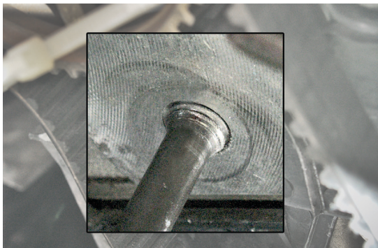
Fig. 1: De tapbout is niet correct ingeschroefd
